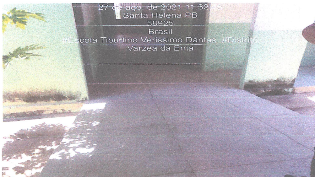
Foto 02: Rampa a ser colocada corrimão.
